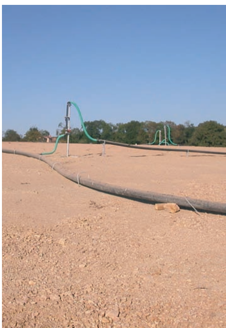
Réseaudage captage sur le dôme de la zone n°1
